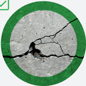
Béton, y compris ferrailé
